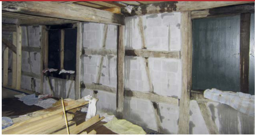
1 Die Folgen einer intensiven Schlagregenbelastung werden bei Sicht-Fachwerk oft unterschätzt. Das Eindringen einer solchen Feuchtemenge kann nach dem Aufbringen einer Innendämmung zu erheblichen Schäden bei der Wandkonstruktion führen. Daher ist man gut beraten, die Feuchtebelastung vorher zu klären.
