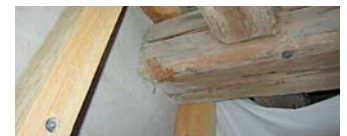
Ein Riss in den Balkenköpfen kann eine Leckage darstellen.
