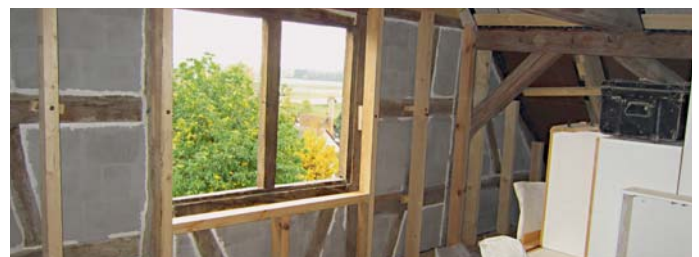
Die Anschlussfugen zwischen Ausfachung und Riegel wurden sorgfältig nachgebessert, damit der Schlagregen nicht mehr so leicht eindringen kann.
