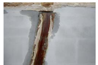
Der Schlagregen drückt durch alle Ritzen.
