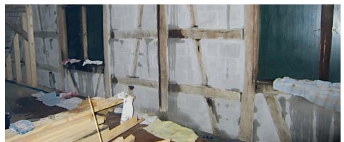
Schlagregen auf der Innenseite einer Riegelwand.
